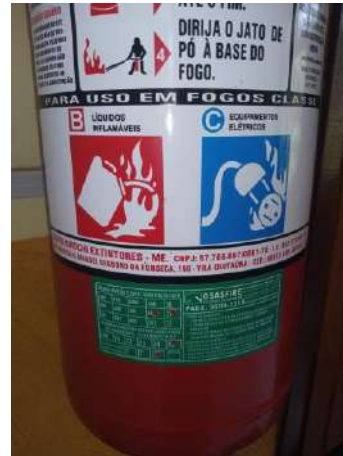
Foto 72: Extintor dentro da validade
