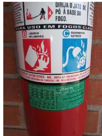
Foto 74: Extintor dentro da validade
